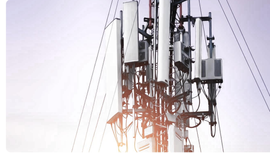
Telecomunicaciones e instalaciones críticas
